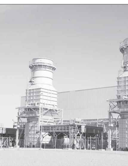
واحدهای نیروگاه سیکل ترکیبی بمپور و نیروگاه گازی زاهدان
